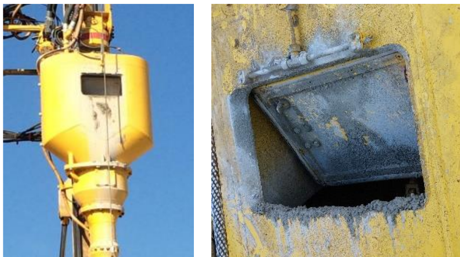
Rys. 52 – Podwójna śluza DLS: ogólny widok (po lewej) i dolny rant klapy po próbach (po prawej) z osadami betonu porowatego.
