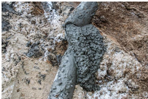
Rys. 26 – Uszkodzenie przewodu tłocznego w wyniku zatoru mieszanki betonowej.
